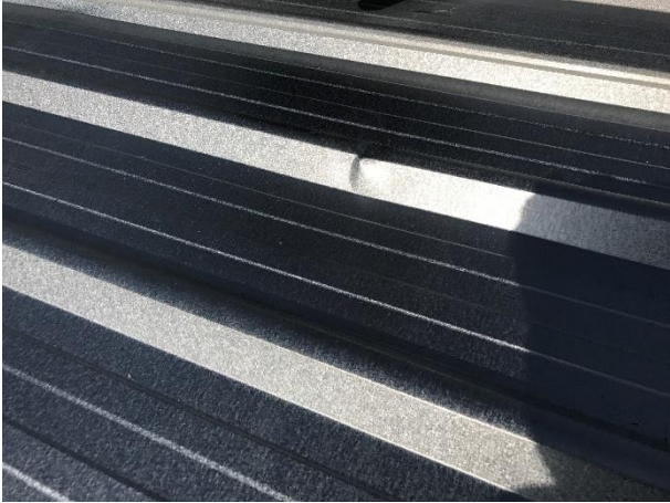
การซ่อมแซมกรณีลอนบุบ เนื่องจากการเหยียบ หรือทำเครื่องมือตกกระแทกบนหลังคา
